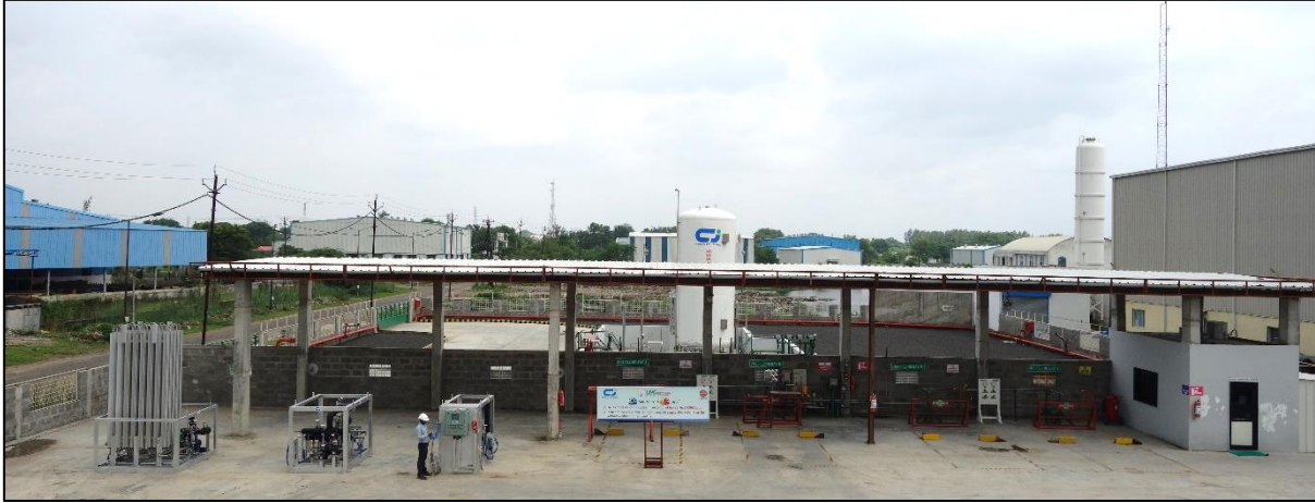
Courtesy : Cryogas equipment Pvt Ltd & LNG Express (India) Pvt Ltd
